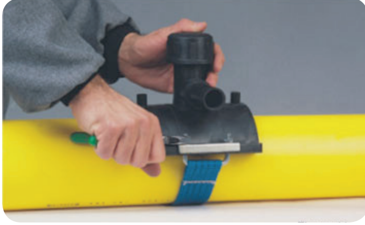
Te-branşmanın kaynak öncesi boru üstünde sıkılması/ Tightening of Tee-branch on the pipe
